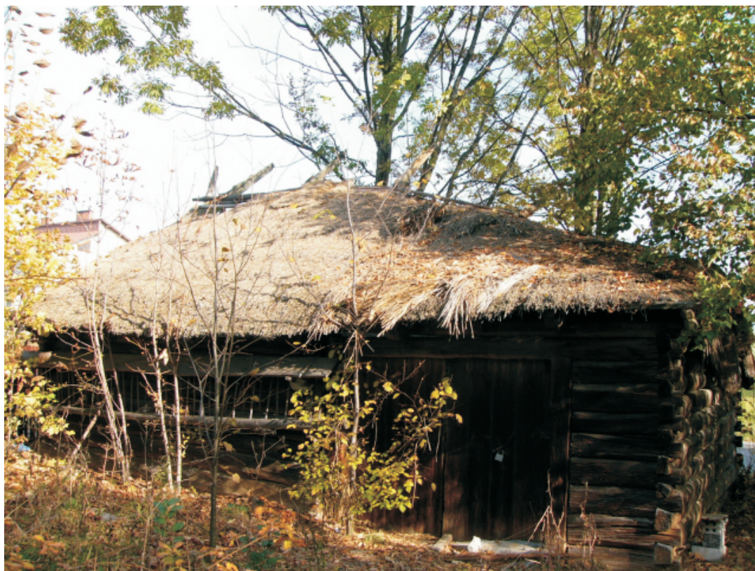
27.Obiekt: Stodoła I w zagrodzie nr 402, użytkowanie - nie użytkowany, budynek drewniany, datowany na 1880 r., działka ewid. nr 1792, adres - Wola Zarczycka nr 402, własność - prywatna, stan zachowania - bardzo zły, informacja o ochronie - Decyzja nr A-759 z 21 kwietnia 1974 r., karta ewidencyjna biała, uwagi: dach kryty strzechą, Karta Gminnej Ewidencji Zabytków nr: 30/1719
