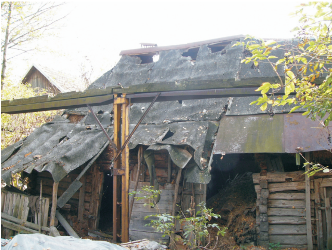
14. Obiekt: Stajnia w zagrodzie nr 519, użytkowanie - nie użytkowany, budynek drewniany, datowany na początek XX w., działka ewid. nr 13476, adres - Wola Zarczycka nr 519, własność - prywatna, stan zachowania - bardzo zły, Karta Gminnej Ewidencji Zabytków nr: 17/1719
