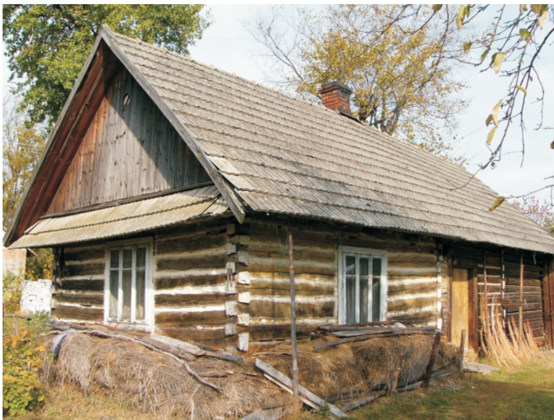
24. Obiekt: Dom nr 581, użytkowanie - pomocnicze, budynek drewniany, datowany na 1905 r., działka ewid. nr 14245, adres - Wola Zarczycka nr 580, własność - prywatna, stan zachowania - zły, uwagi: dach kryty dachówką, przebudowany ok. 1985 r., Karta Gminnej Ewidencji Zabytków nr: 27/1719
