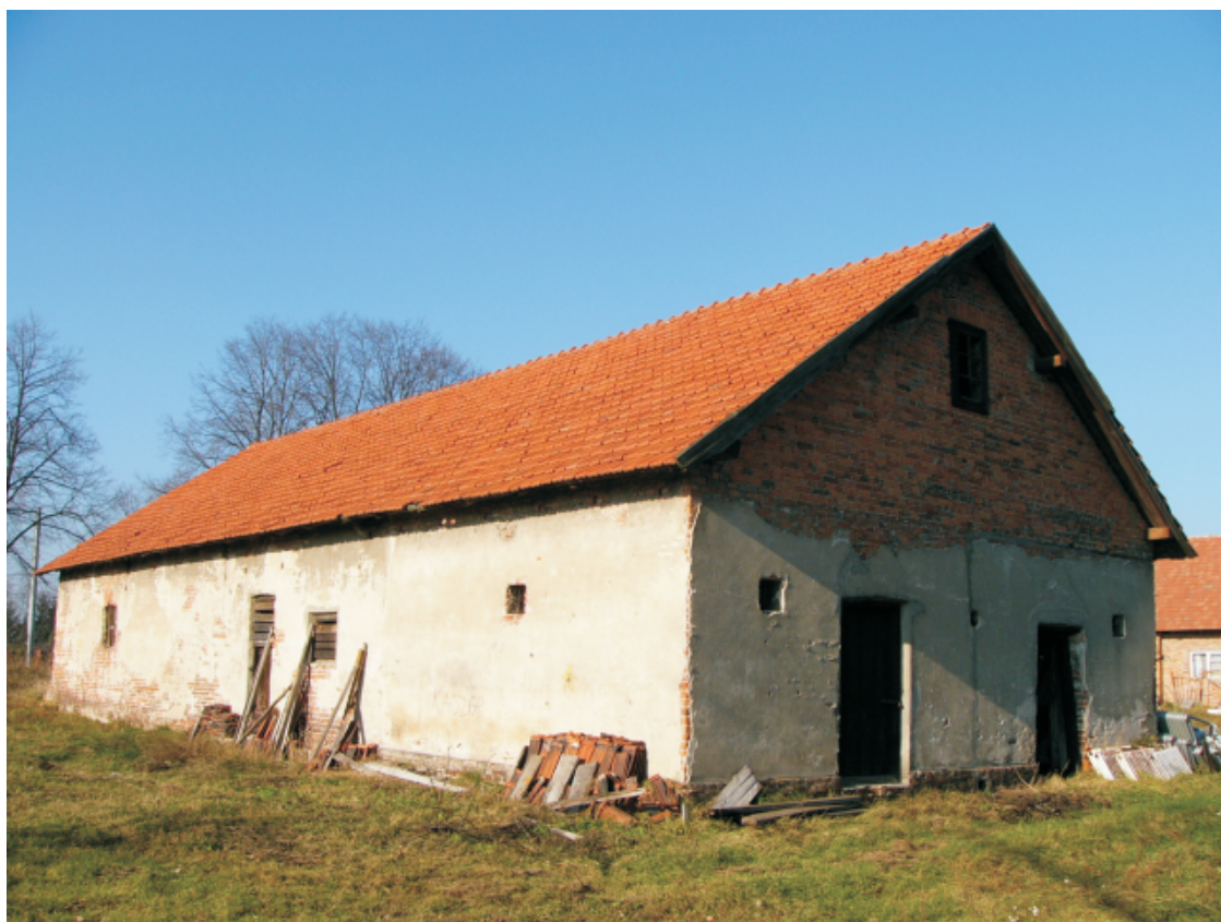
5. Obiekt: Obora w zespole kościoła parafialnego p.w. św. Sebastiana, użytkowanie - pomocnicze, obiekt murowany, datowany na pocz. XX w., lokalizacja - przy kościele parafialnym, działka ewid. nr 2620, własność - wyznaniowa, stan zachowania - zły, uwagi: remont w 2006 r., dach kryty dachówką, Karta Gminnej Ewidencji Zabytków nr: 74/1719
