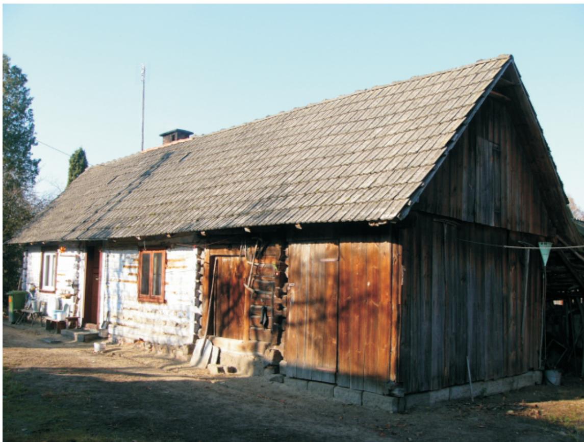
7. Obiekt: Dom nr 284, użytkowanie - mieszkalne, budynek drewniano, datowany na ok. 1910 r., działka ewid. nr 4589, adres: Jelna nr 284, własność - prywatna, stan zachowania - zły, uwagi - dach kryty dachówką, dom z pomieszczeniami gospodarczymi, Karta Gminnej Ewidencji Zabytków nr: 69/1719
