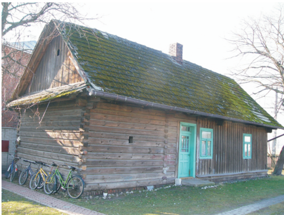
3. Obiekt: Dom w zagrodzie nr 129, użytkowanie - mieszkalne, budynek drewniany, datowany na 3 ćw. XIX w., działka ewid. nr 627/1, adres: Tarnogóra nr 129, własność - prywatna, stan zachowania - zaniedbany, uwagi: przebudowany w 1920 r., dach kryty dachówką, Karta Gminnej Ewidencji Zabytków nr: 57/1719
